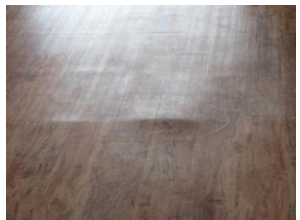
Pløser og buler på gulvbelegg
