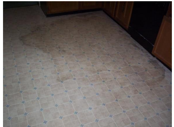
Misfarging på gulvbelegg
